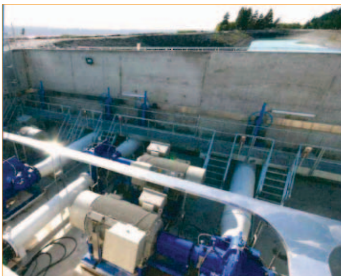
Actual Water Pump
